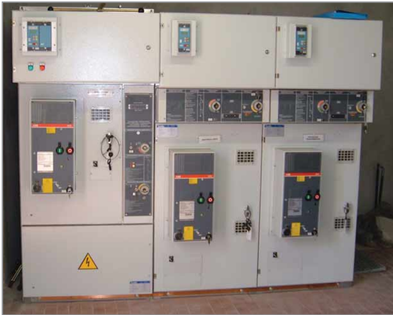
Cabina MT 15 kV, con protezioni elettroniche conformi alla DK5600, tutta la cella è interamente supervisionata e controllata dal sistema bus
