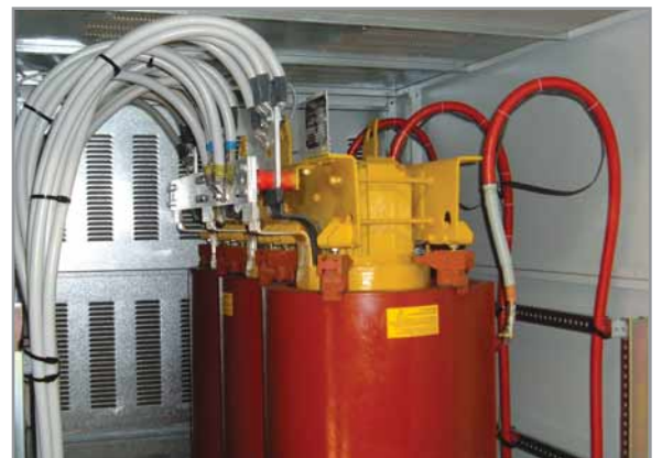
Trasformatore MT/bt 15/0,4 kV - 630 kVA interamente supervisionato dal sistema bus
