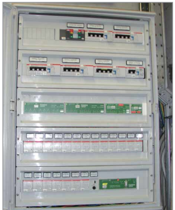
Quadro elettrico di controllo illuminazione e supervisione tecnologica degli impianti
